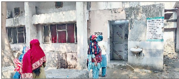
सोनीपत। नागरिक अस्पताल परिसर में अलग से बनाए गए महिला शौचालय परिसर के बाहर खड़ी महिलाएं व स्टेशन पर महिला शौचालय में खराब हालत में लगी सैनेटरी पैड वॉडिंग मशीन।
